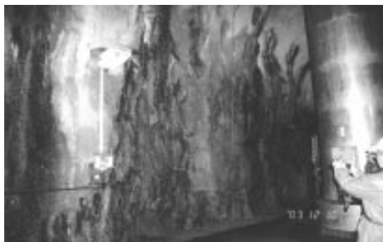
写真7 坑道内部。水が垂れている様子。
