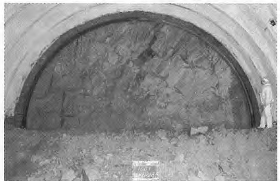
第12図 本村側切羽写真2. 坑口から1,010mの檜山溶岩結晶質部分(H9-1).
