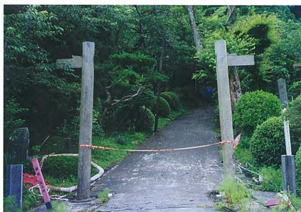
2. 矢本町大塩新山神社の鳥居の破損. 両側の柱は倒壊せず, 笠部と貫部が落下している.
