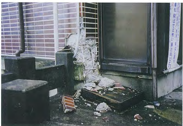
5. 鹿島台町役場庁舎の損壊. 庁舎は斜面に立地しており, 斜面上部に当たる北西隅の基礎部分が損壊した.
