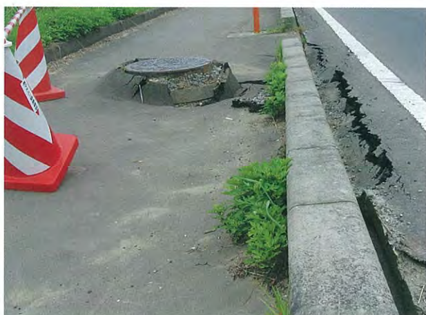
4. 道路面の陥没とマンホールの抜け上がり(矢本町小松町宮住宅南).
