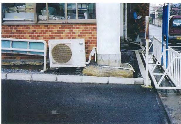
6. 涌谷町役場新庁舎の基礎部分の抜け上がり. 周辺の地盤が沈下し, 建物基礎部分が抜け上がっている. 抜け上がりは5月26日の地震でも発生し, 7月26日の地震でさらに大きくなった.
