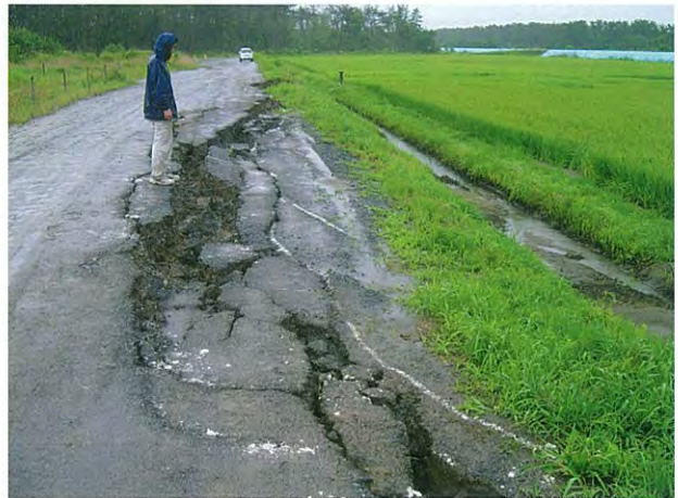
4. 液状化によって崩壊した農道(鳴瀬町牛網南部). 噴砂を伴う大きな亀裂が発生して, 道路面が水田方向へ崩れている.
