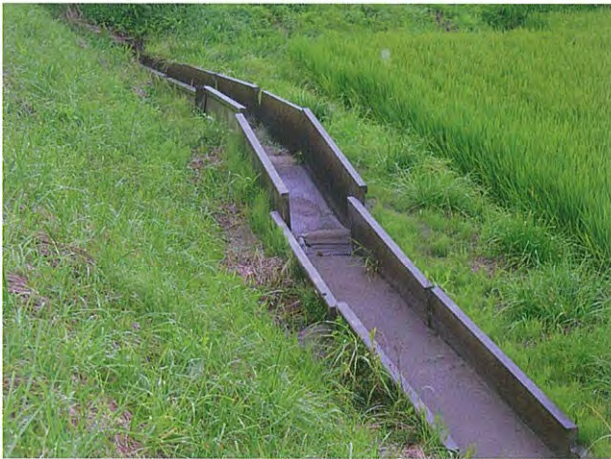
3. 液状化による水路のU字溝被害(鳴瀬町浜市南部). U字溝内に噴きあがった砂・泥が堆積している.
