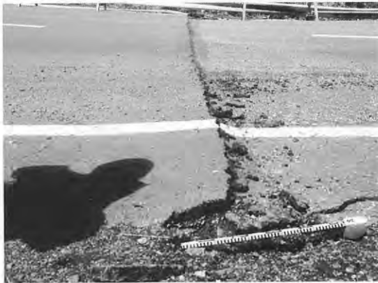
写真3 旭山南の県道路面の圧縮性亀裂 (第2図の地点2).
