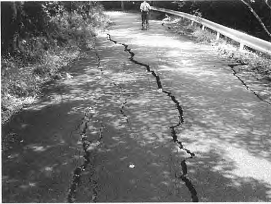
写真2 旭山登山道の路面の亀裂 (第2図の地点1付近).
