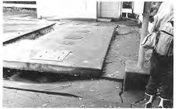
写真1 旭山登山道駐車場の浄化槽周辺の陥没(第2図の地点1)。
