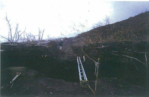
9. はちまき道路では、泥流によって道路が所々大きくえぐられており、車両の通行が不能となっている。この場所では工事用の支柱が架けられている。
