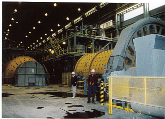
6. カホネ鉱山の粉砕室の巨大なボールミルとロッドミル。
