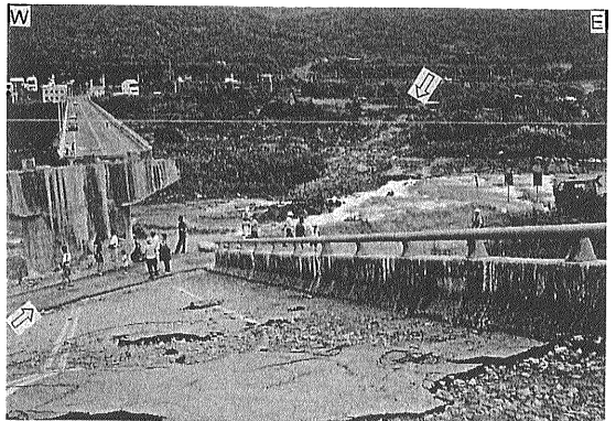
写真2 埤豊橋の落橋と断層崖(Loc.5)。橋脚間あるいは橋脚直下に出現したN36°E方向の地表地震断層により橋脚が転倒し、上部工が落橋している。上流側に出現した断層崖によって滝が形成されている。
