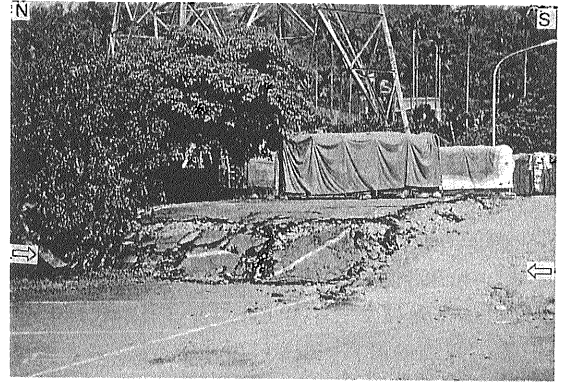
写真9 駐車場を横断する断層崖 (Loc.13). 断層崖近傍のアスファルト舗装面は破損するが, 離れたところでは大きな被害は見られない. 背後の鉄塔にも被害は見られない.
