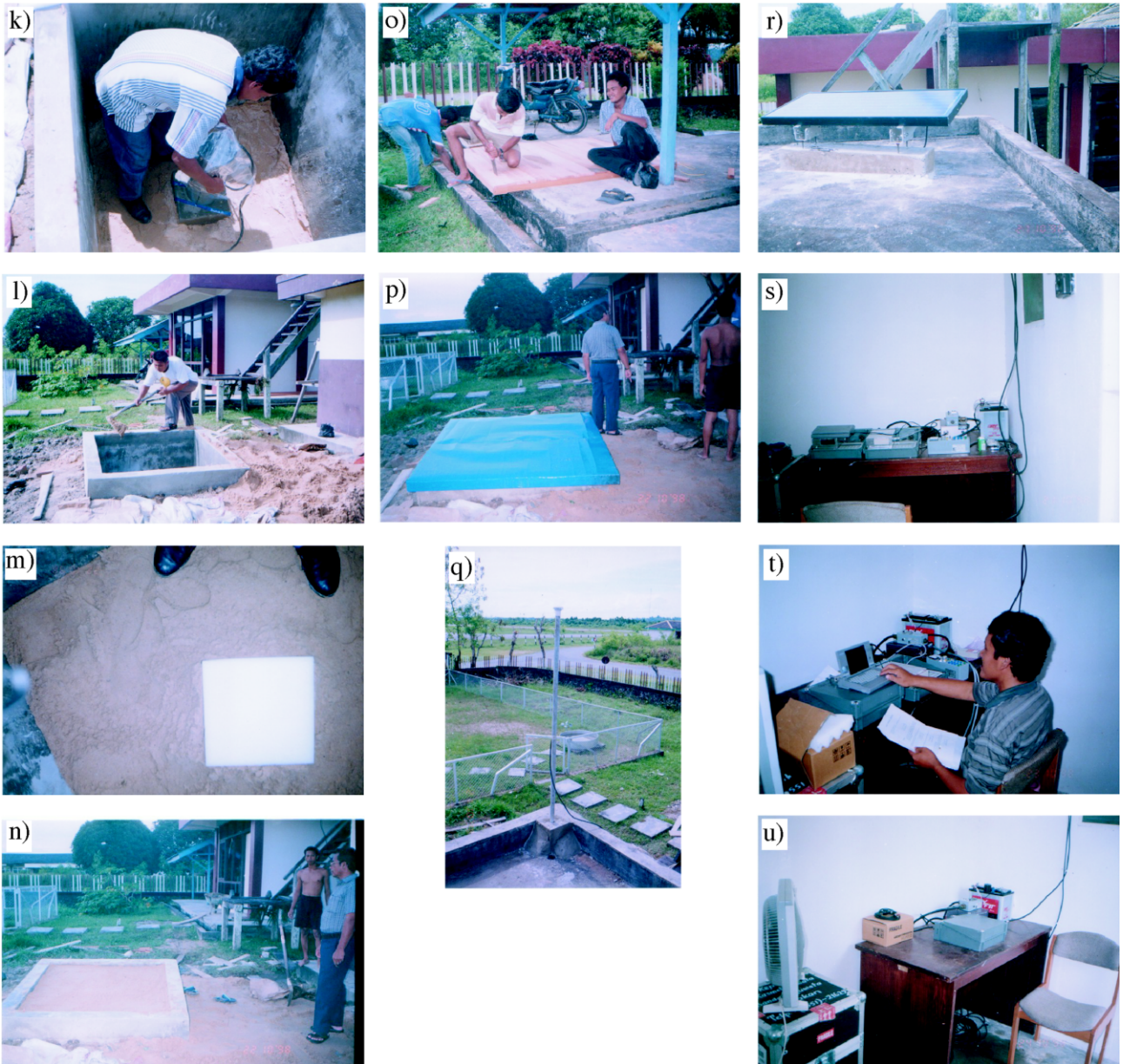
第3図 k) 地震計の上面にビニールの覆いを被せる. l) 地震計室内に砂を慎重に入れる. m) 地震計の上面に発泡スチロールの蓋を置く. n) 地震計室の上面まで砂を入れる. o) 地震計室の蓋の作成. p) 蓋を地震計室に被せる. q) GPSアンテナを観測施設の屋上に設置する. r) ソーラーパネルを観測施設の屋上に設置する. s) レコーダを観測施設内に設置する. レコーダが2台あるがそのうちの1台は予備である. t) レコーダに観測パラメータを設定する. u) 作業終了.
