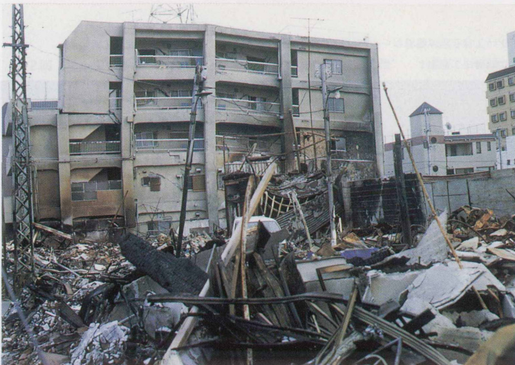
第7図 火災によって建物が焼失した区画。火災によって木造家屋が焼失し廃墟と化している。ここでは、写真奥の鉄筋コンクリート造建物の柱がせん断破壊し、地震動そのものによる被害も大きかったと推定できる。
