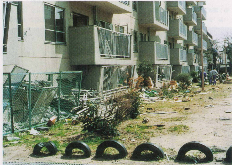
第4図 神戸市東灘区における鉄筋コンクリート造の建物の被害。10階建ての建物の柱がせん断破壊し、1階部分が潰れている。
