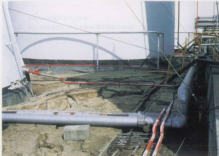
第8図 神戸市長田区の海岸付近埋立地における液状化による被害。液状化によって地面に亀裂・段差を生じるとともに、石油タンクが傾いている。
