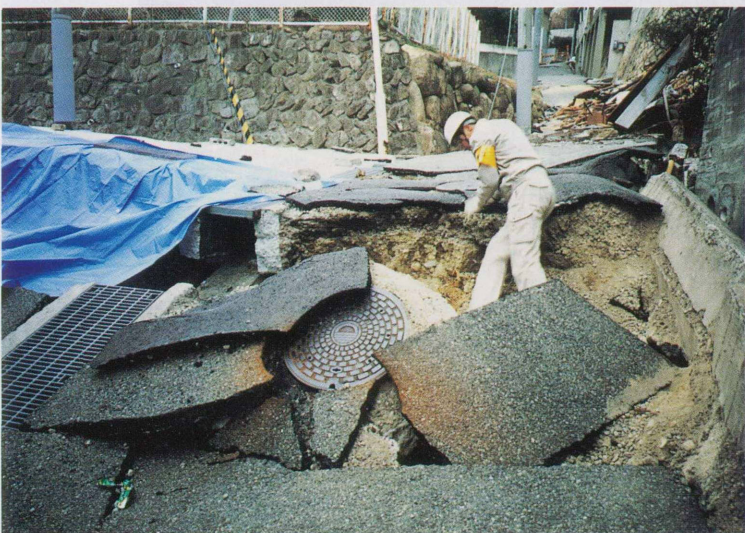
第9図 芦屋市三条町における人工谷埋め・盛り土に関連した地すべり。地すべりの頭部に発達するクラックで、約1mの落差を伴っている。
