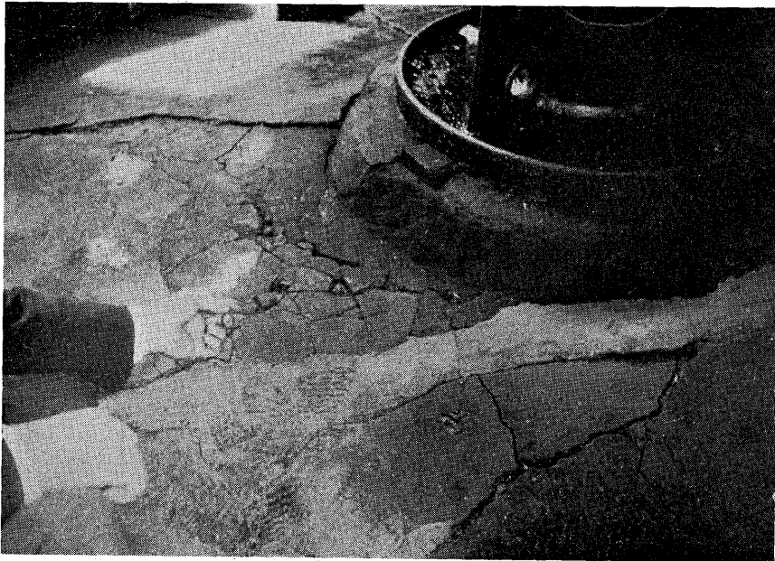
図版2 地盤沈下によって生じる井戸台枠のコンクリート基礎の破砕状況。井戸側管が抜け上がり、それに伴ってコンクリートに亀裂がはいり、修理せずに放置するとこの写真のようになる。墨田区吾嬭町明治製菓の工場深井戸
