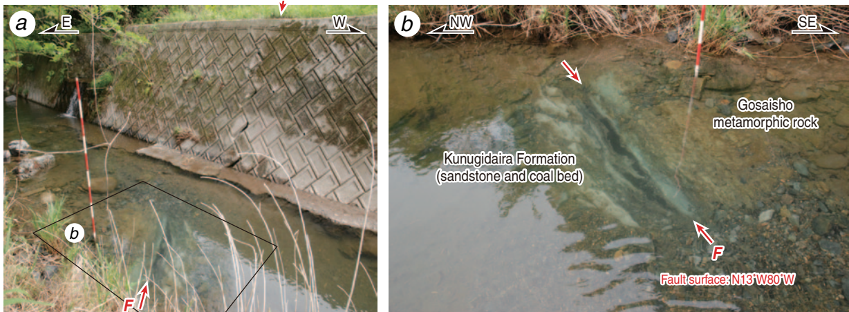
第 15 図. a) 遠野町釜ノ沢を流れる天ノ川右岸側護岸擁壁を切断する地表変位の写真. 地表変位を矢印で示す. 南に向かって撮影. b) 天ノ川河床にみられる御齋所変成岩 (東側) と堆積岩 (西側) の境界をなす井戸沢断層 (矢印で示す). 第 15 図 a の擁壁の破壊箇所の延長部河床に位置する. 北北西に向かって撮影.
