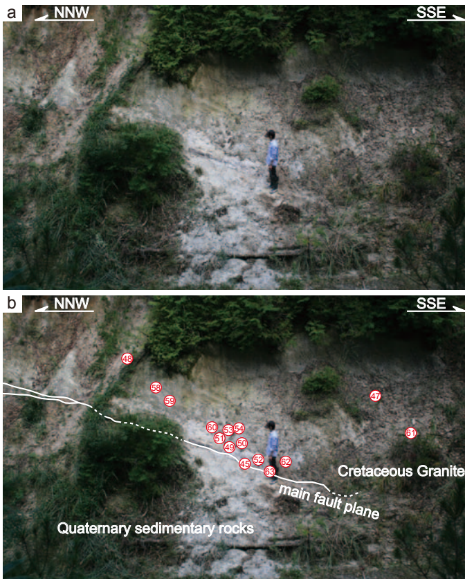
第7図. (a) 田瀬地域に見られる阿寺断層系の露頭写真. (b) aに主断層面, 断層スリップデータを取得した位置を書きこんだ図. Fig. 7. (a) Photograph of the Atera fault system in Tase area. (b) Locations of main fault plane and fault-slip data of (a).
