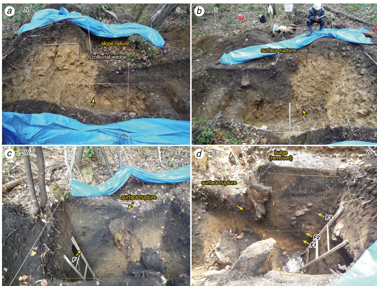
第 19 図. 荒砥沢ダム北方地点の東および西トレンチに出現した地断層. a) 東トレンチ東壁面. b) 東トレンチ地点西壁面. c) 西トレンチ北壁面. d) 西トレンチ南壁面. 詳細は本文参照.
