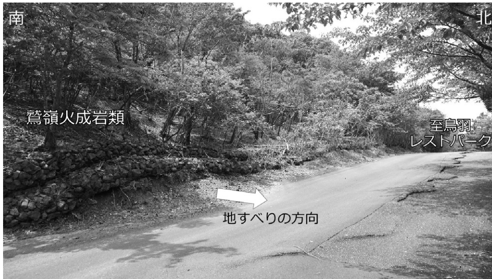
第 11. 2 図 鷺嶺火成岩類(御荷鉾緑色岩類)の地すべり 地すべりによって、石垣や亀裂を伴ったアスファルトが北方へ変位している。また、土砂が石垣を押し上げ下からはみ出している。場所は、行者山南方(鳥羽レストパーク入口東方)。
