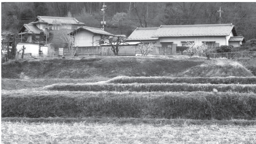
第8.2図 太田断層の低断層崖と推定される崖 桐生市広沢町三丁目(地点F5:第7.2図D参照)。 扇状地面上に比高2~3 m程度の低崖が形成されている。家がのる面の手前の崖、南方を望む。
