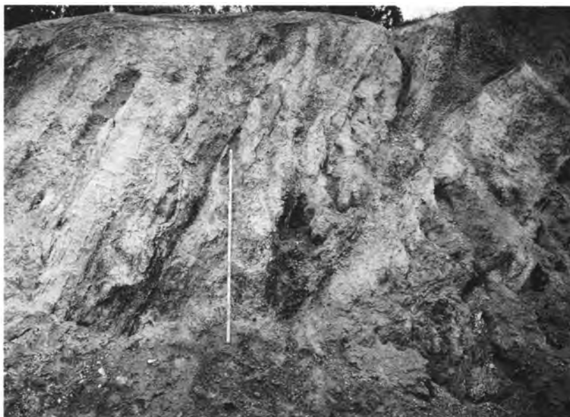
第60図 山下層における急傾斜の地層（山元町久保間付近） 拗曲構造の一部。岩相は凝灰質砂岩とシルト岩の互層（吉岡敏和技官提供）
