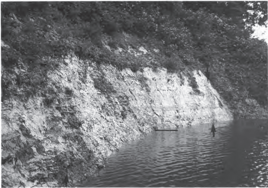
第72図 二庄内川沿いにみられる虹ノ湖断層の露頭。矢印間が破碎帯、黒色太線が約1m
