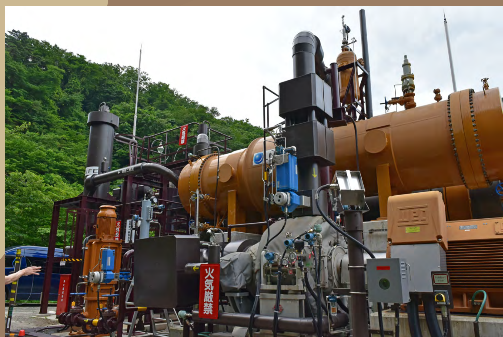
土湯温泉バイナリー発電所（福島県）
