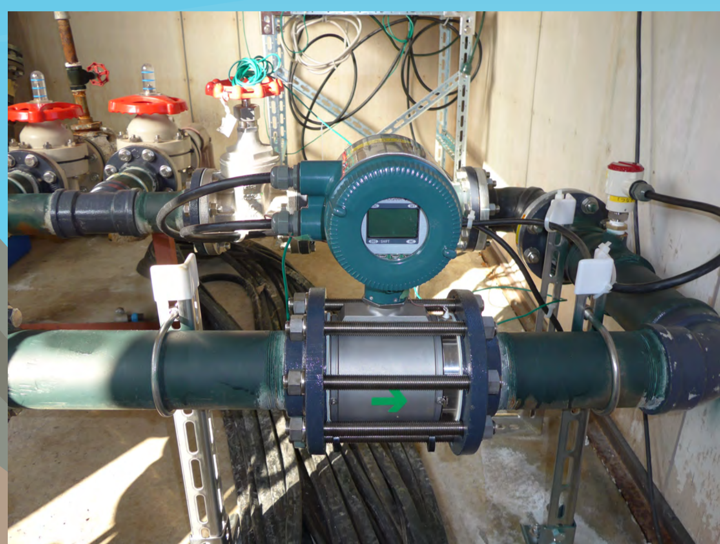
産総研が開発中の温泉モニタリング装置 (温泉の温度、流量、電気伝導度を測定)
