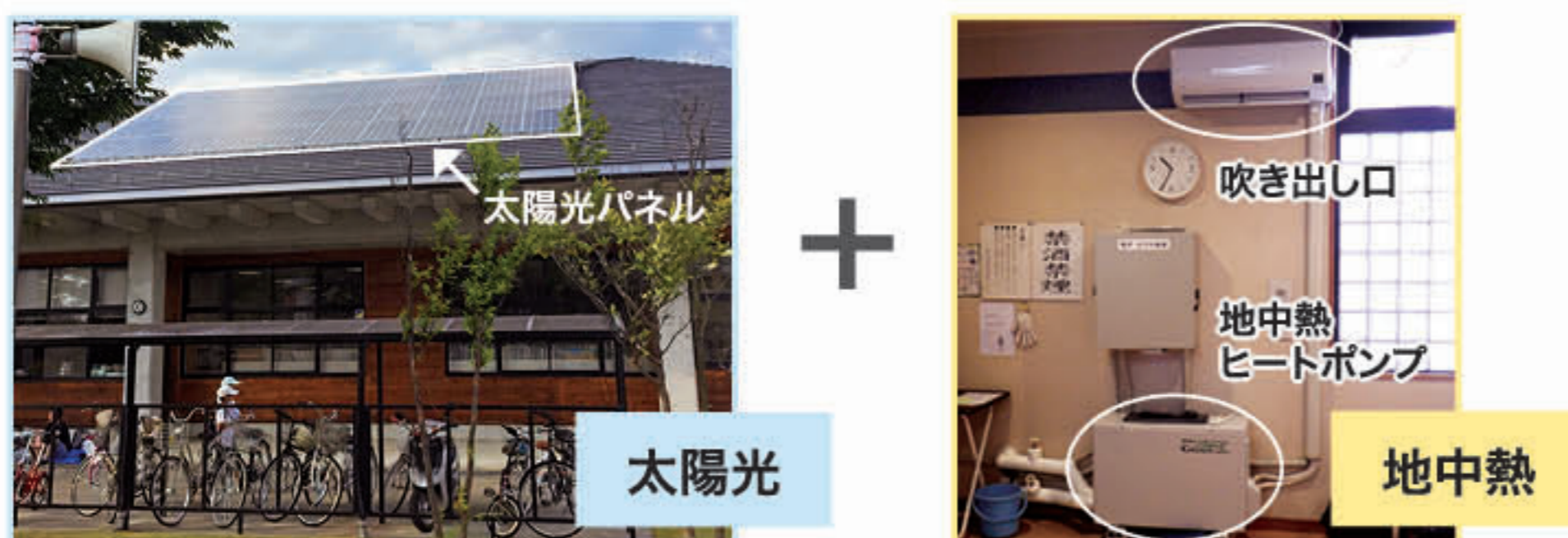
図3 喜久田公民館の太陽光発電量と地中熱ヒートポンプ消費電力の利用条件。外観（左）、地中熱ヒートポンプ設置の様子（右）。
