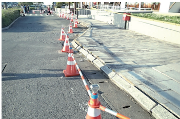
(撮影：大阪市立大学 中條 壮大) ⑤ 熊本港フェリー乗り場 沈下による舗装被害
