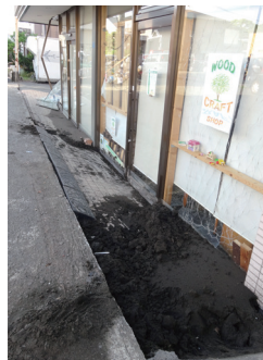
(撮影：熊本大学 松田泰治) ⑨ 液状化現象による家屋の沈下
