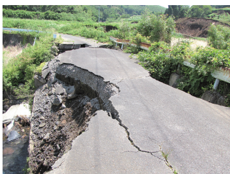
（撮影：熊本大学 山尾敏孝） ⑤ 鉄瓶橋の被災状況
