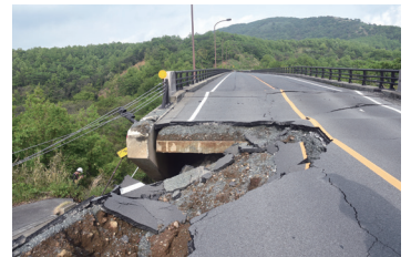
(撮影：熊本大学 葛西 昭) ④ 橋桁の座屈被害(俵山大橋)
