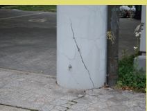
クラックが入った南側玄関の支柱館の躯体の広範囲にこのようなクラックが生じた（2016年4月18日撮影）
