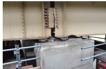
(撮影：熊本大学 葛西 昭) ③ 橋脚の支承の破損(秋津川橋)
