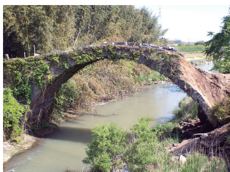
（撮影：熊本大学 山尾敏孝） ④ 安見下鶴橋の右岸側の両壁石の崩壊
