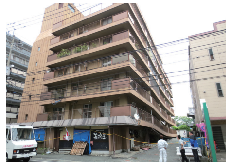
(撮影：熊本大学 柿本竜治) ⑥ ピロティの駐車場が潰れたマンション
