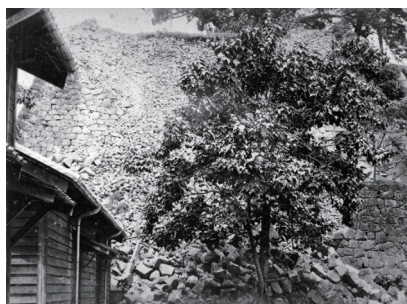
② 旧熊本城飯田丸 第六師団弾薬庫上石垣崩壊
