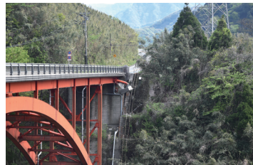
(撮影：熊本大学 葛西 昭) ② ダンパー部に損傷が見られる南阿蘇橋
