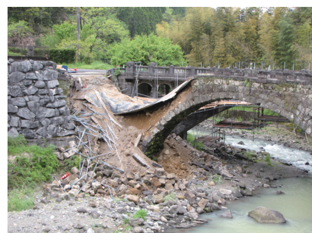
（撮影：熊本大学 山尾敏孝） ⑥ 二俣福良渡の右岸側の両壁石の崩落
