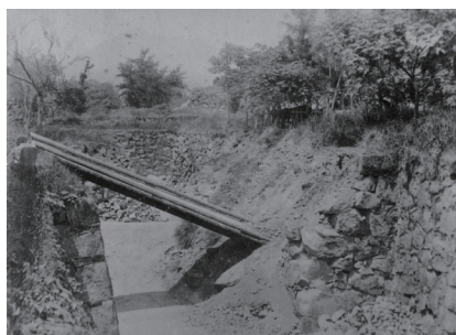
① 旧熊本城間ガリ 第六師団本部石垣崩壊
