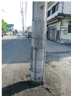
(撮影：熊本大学 松田泰治) ⑧ 液状化現象により電柱が約1m沈下した
