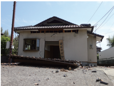
(撮影：熊本大学 松田博貴) ⑦ 4月14日発生の前震によりひさし部分が脱落した益城町寺迫公民館
